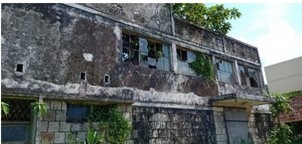
Gambar 4. Pabrik batik yang sudah terbengkalai
