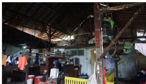
Gambar 9. Struktur atap workshop batik Oey Soe Tjoen yang terbuat dari kayu dan bambu (Sumber: Widyasari, 2017)
